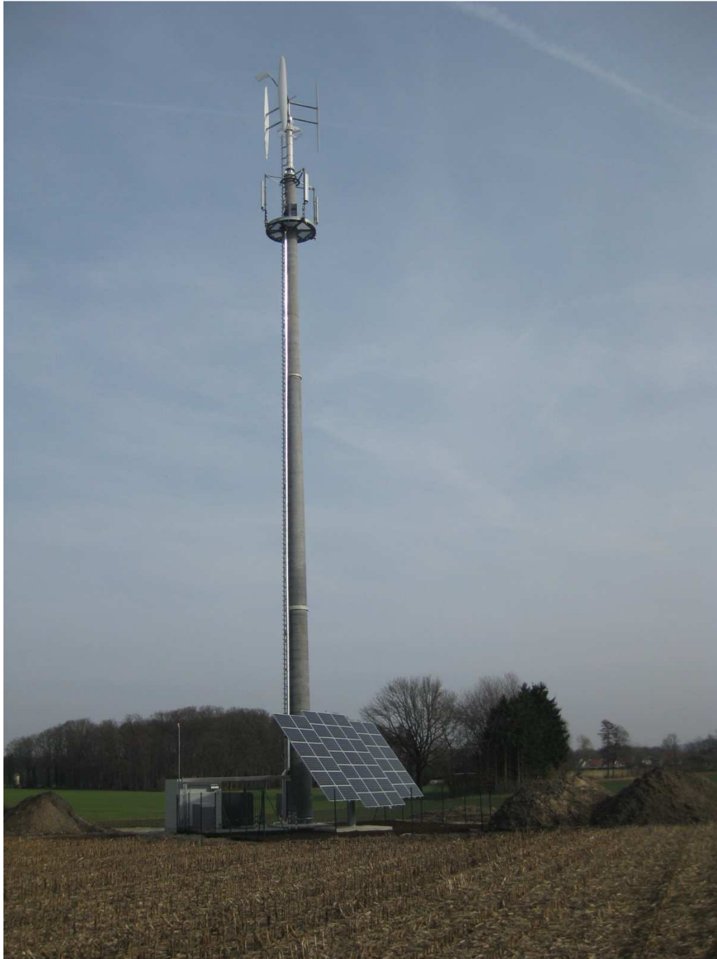
Bild: Mobilfunkstation mit komplett autarker Stromversorgung
